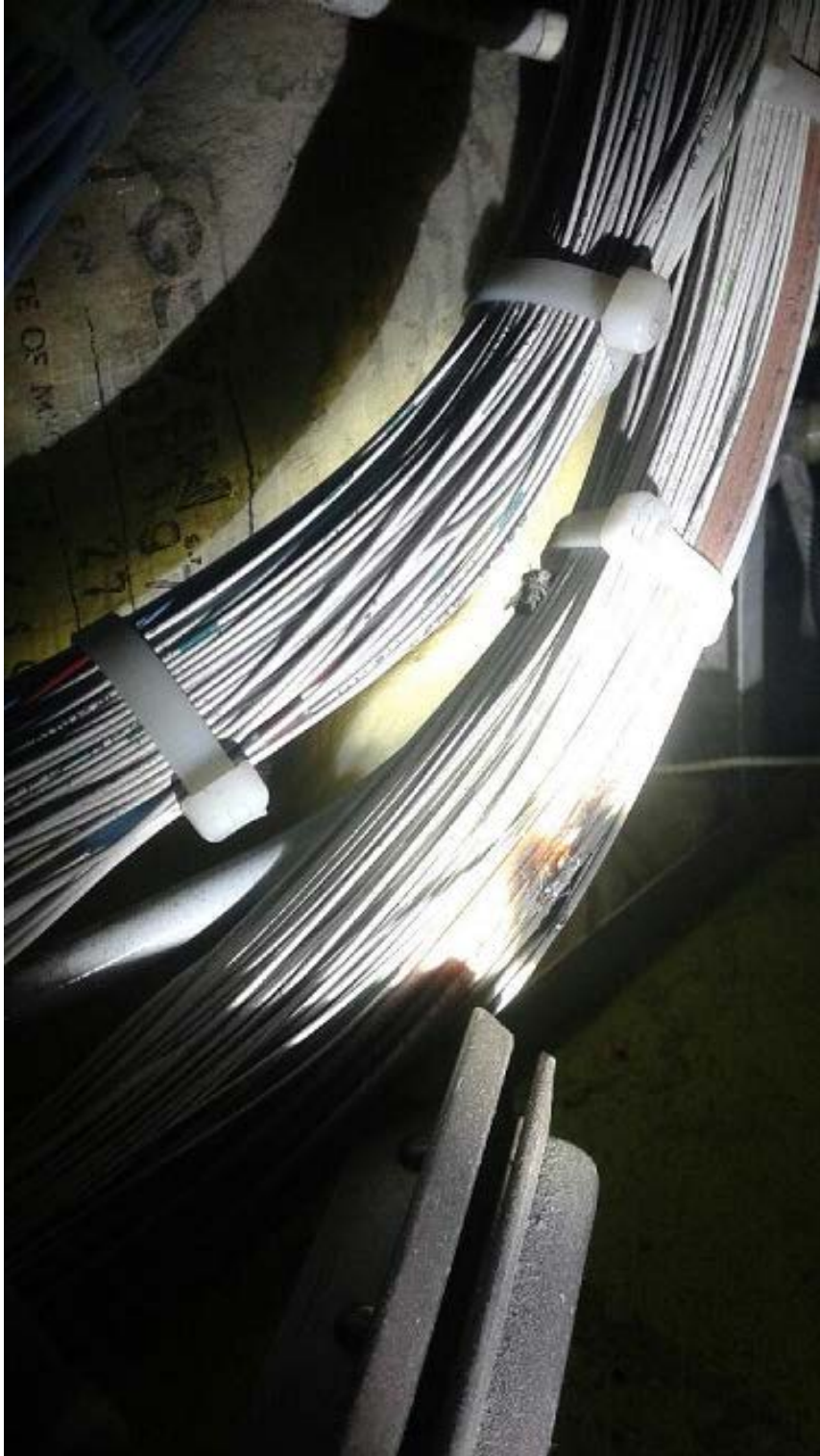
Indication d'arc électrique sur les fils
