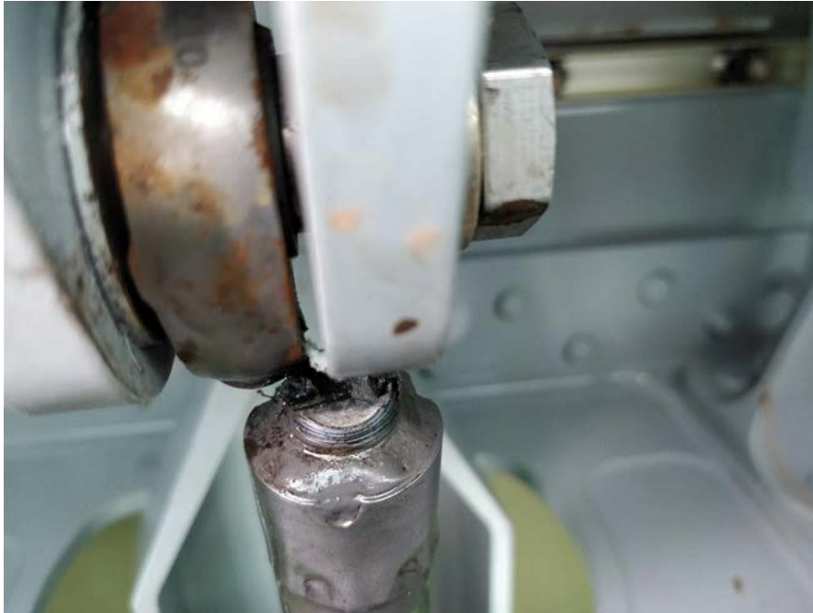
Chape de tige cisailée avec corrosion visible
